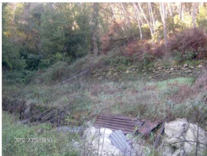
FOTO 7 - Terrazzamento stabile tra lo stradello interno e l'affluente del Rio Saracino su cui si imposterà il fabbricato n. 13
